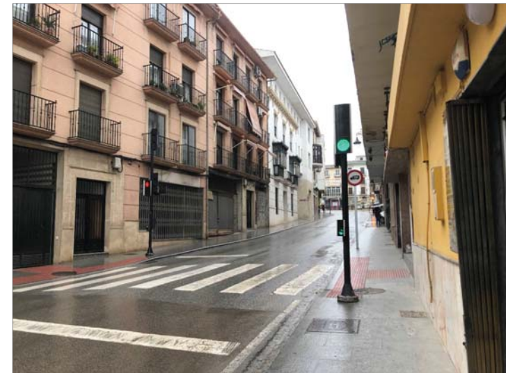
Ilustración 27. Paso de peatones regulado por semáforo. Se aprecia continuidad acera-paso. Falta el pavimento táctil direccional.
