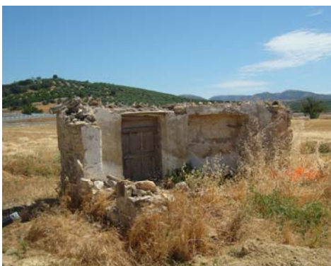
CASETA - ALMACÉN y RUINA EN FINCA nº 67
